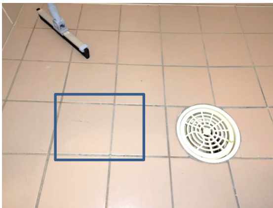
Kuva pesuhuoneen lattialaatta rikkoutunut
