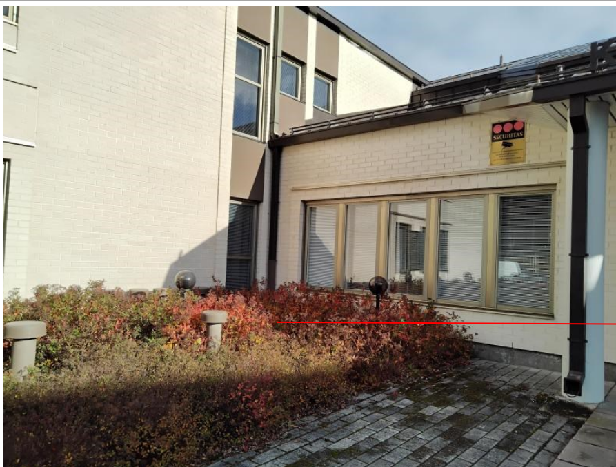
Etupihalla kahden katon vedet ohjataan kaivoon laskevalle putkelle. Putken vesikuorma saattaa olla runsas
