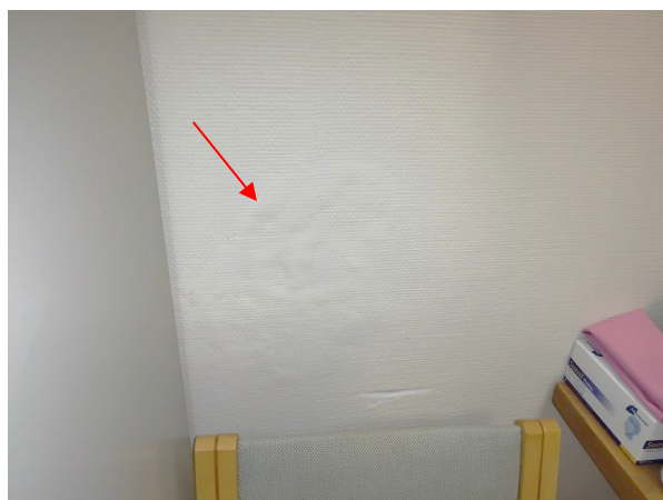
Kuva seinätasoite on irronnut kosteusrasituksen seurauksena
