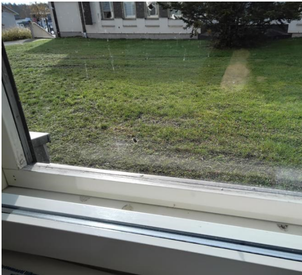
Kuva huonetilan 230 ikkunarakenne, ulkopuitteen maalipinta hilseilee, ikkuna etelään päin
