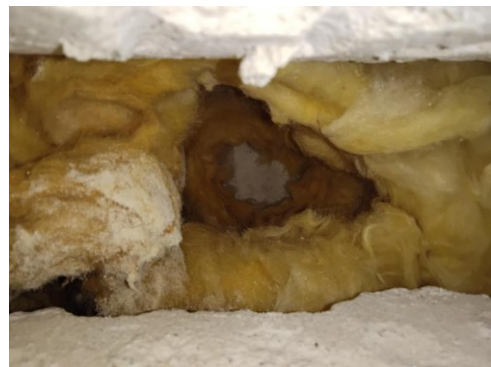
Kuva villa hieman nihkeä, betonin kosteusarvo hieman kohonnut
