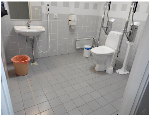
Kuva WC-tilan 316 muutama lattialaatta kopona
