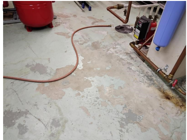
Kuva lämmönjakohuoneen lattian maalipinnoite hilseilee
