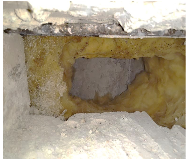
Kuva sisäkuoren betonin pinnalta mitattiin poikkeavia pintakosteuslukemia
