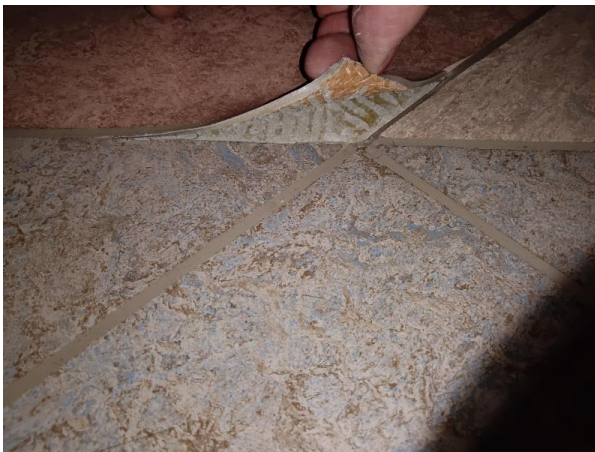
Kuva linoleumaton alta aistittavissa lievää ummehtunutta hajua. Mattoliiman ei todettu olevan saippuoitunutta
