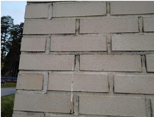
Kuva tiilisaumat paikoin auki, erityisesti kastuneilla seinäalueilla
