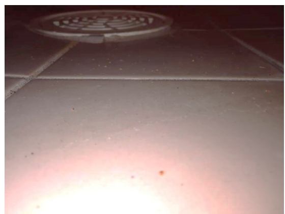
Kuva kaivon reuna lattiapintaa korkeammalla
