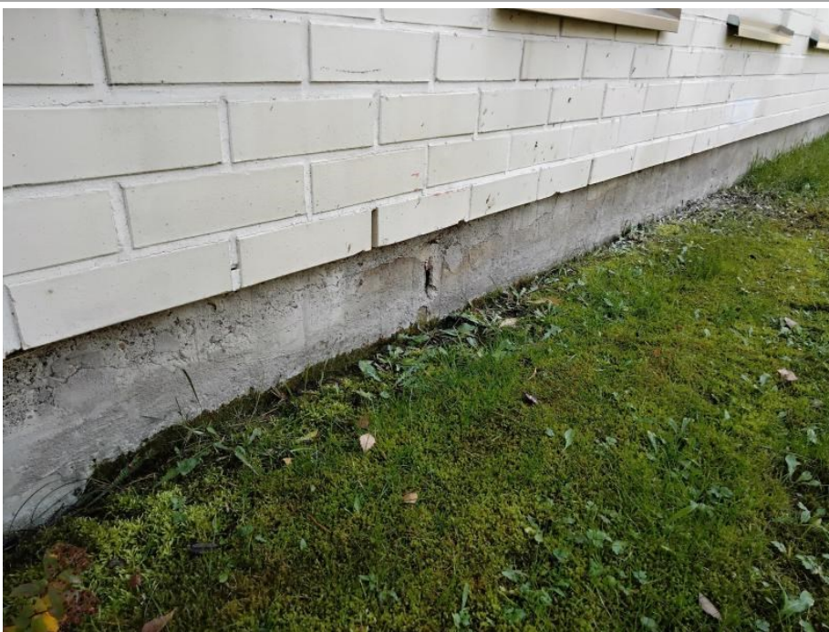
Nurmikko on kiinni rakennuksessa, jonka seurauksena perusmuurin alaosan pinnalla sammalta
