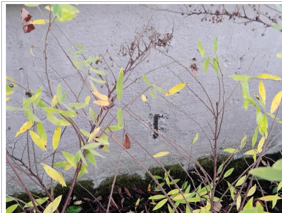
Raudoituksien päältä rapistunut betonipeite
