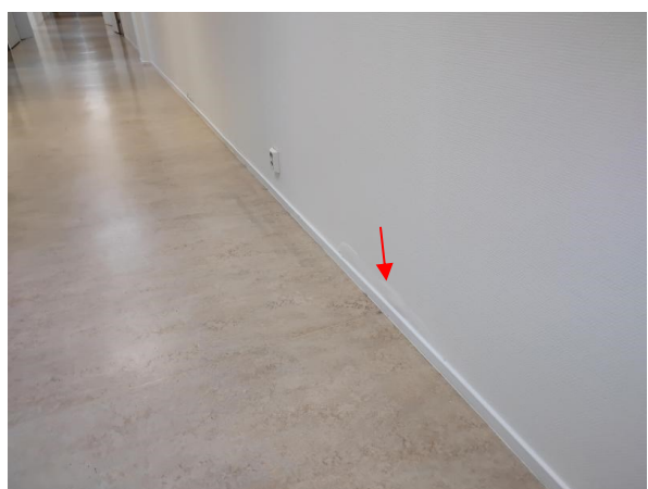
Kuva käytävän seinän maalipinnoite kupruilee kosteusrasituksen seurauksena
