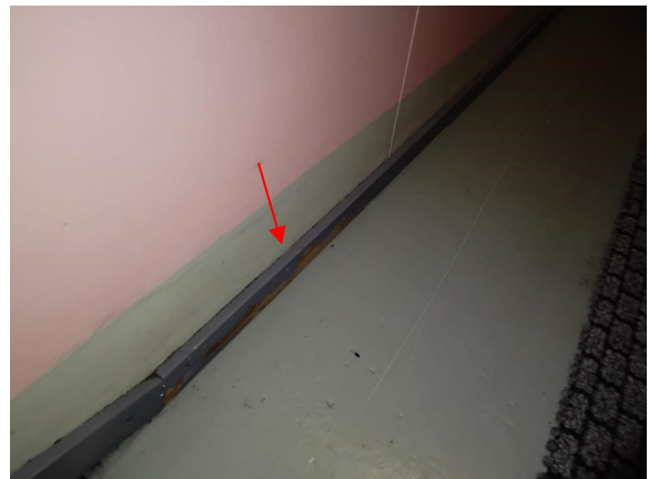
Kuva levyrakenteinen seinä turvonnut alaosaan
