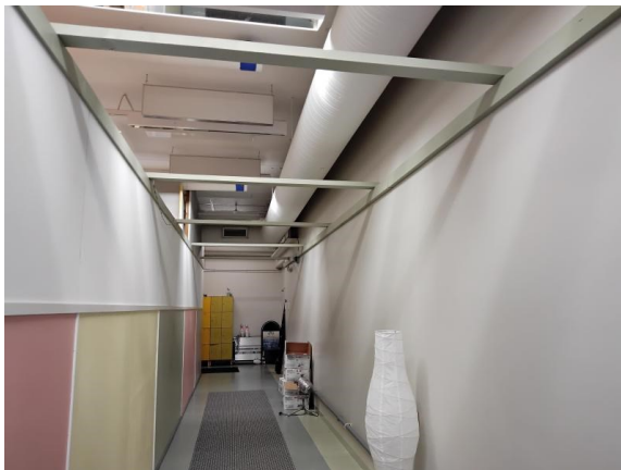
Kuva runsaiden sateiden aikana ulkopuolista kosteutta kulkeutuu keilahalliin alapohjan ja ulkoseinän liittymän kautta
