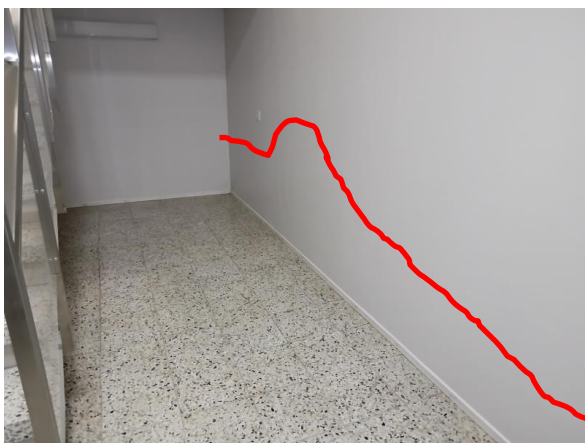
Kuva seinän alaosa, jolta mitattiin poikkeavia pintakosteuslukemia on rajattu valokuvaan punaisella viivalla
