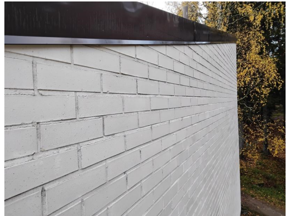
Kuva tiilisaumat paikoin auki, erityisesti kastuneilla seinäalueilla
