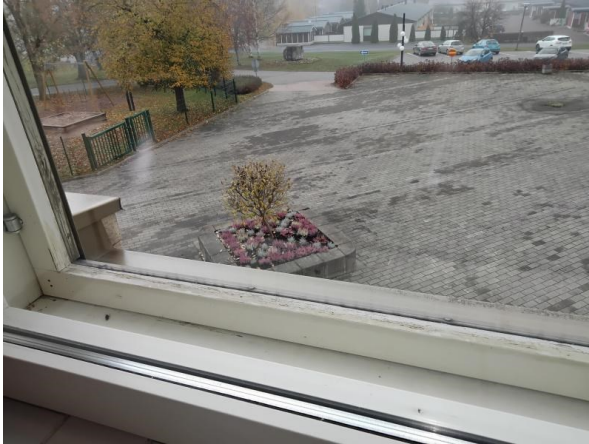
Kuva huonetilan 251 ikkunarakenne, ulkopuitteen maalipinta hilseilee, ikkuna etelään päin
