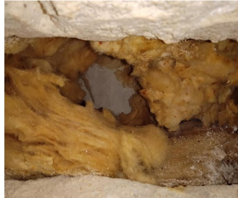
Kuva villa nihkeä, betoni märkää
