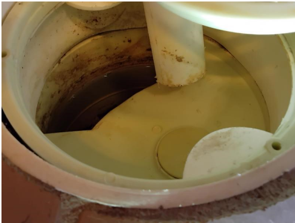
Kuva kaivon ja korokerengkaan liittymä epätiivis useassa kaivossa, korokerengas ei ole symmetrinen kaivoon nähden
