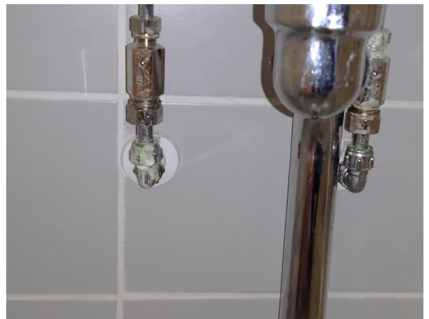
Kuva vesikalusteiden putkissa hapettumia
